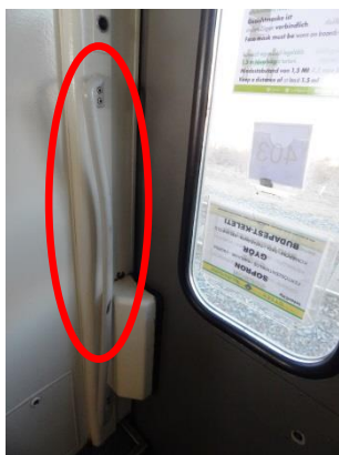
3. ábra: meggörbült kapaszkodó
