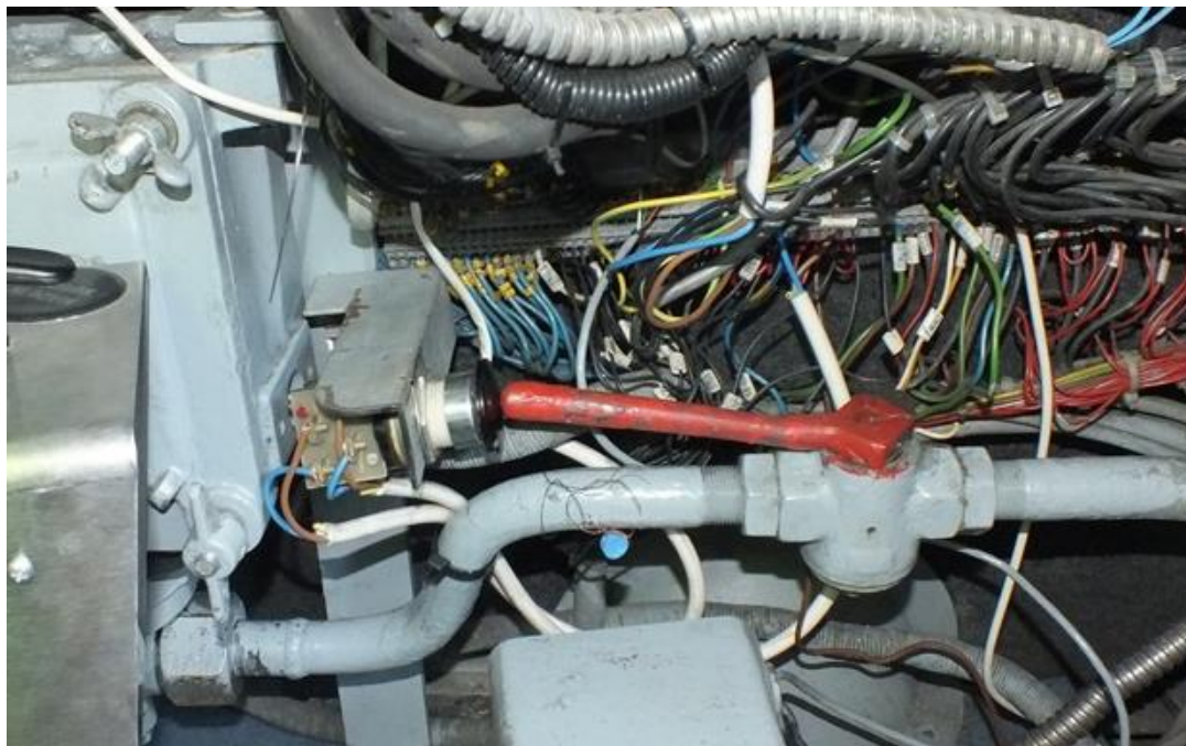
2. ábra: a szakadt plomba (a szelepkar és az általa tartott nyomógomb egymáshoz képest elmozdítható volt)
