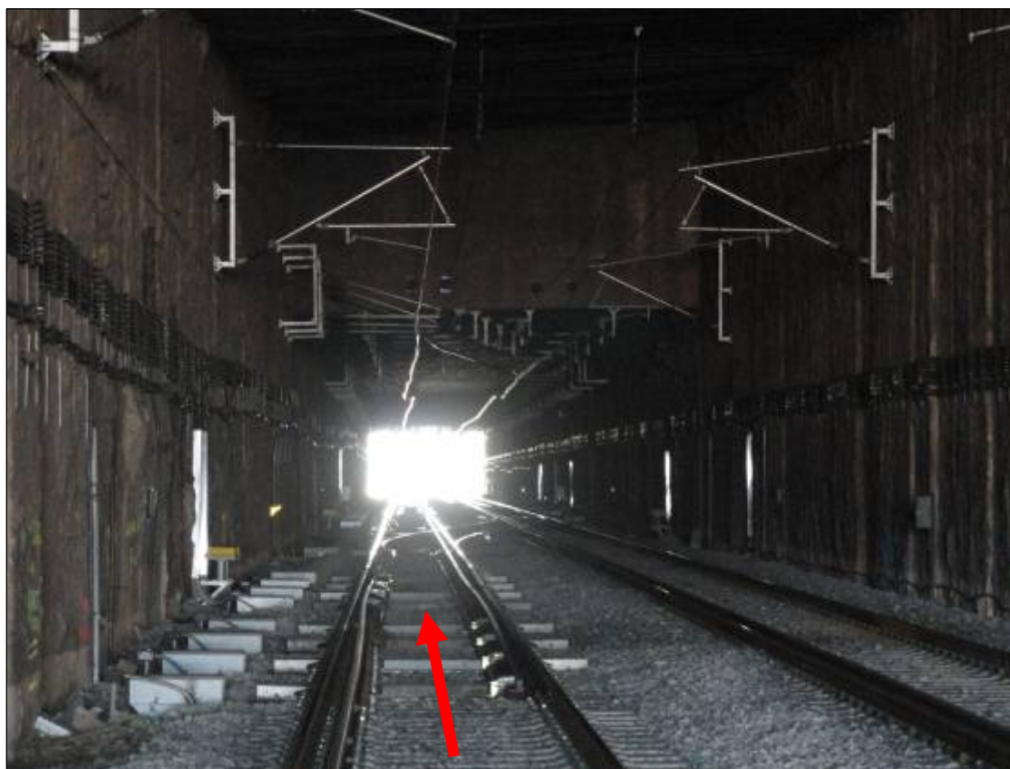
Cambiador de hilo CH6 en vía 1 (vía II banalizada), donde se produjo el descarrilamiento en el interior del túnel, a la salida de la estación de Rubí sentido Mollet Sant Fost y en el sentido de circulación del tren.
