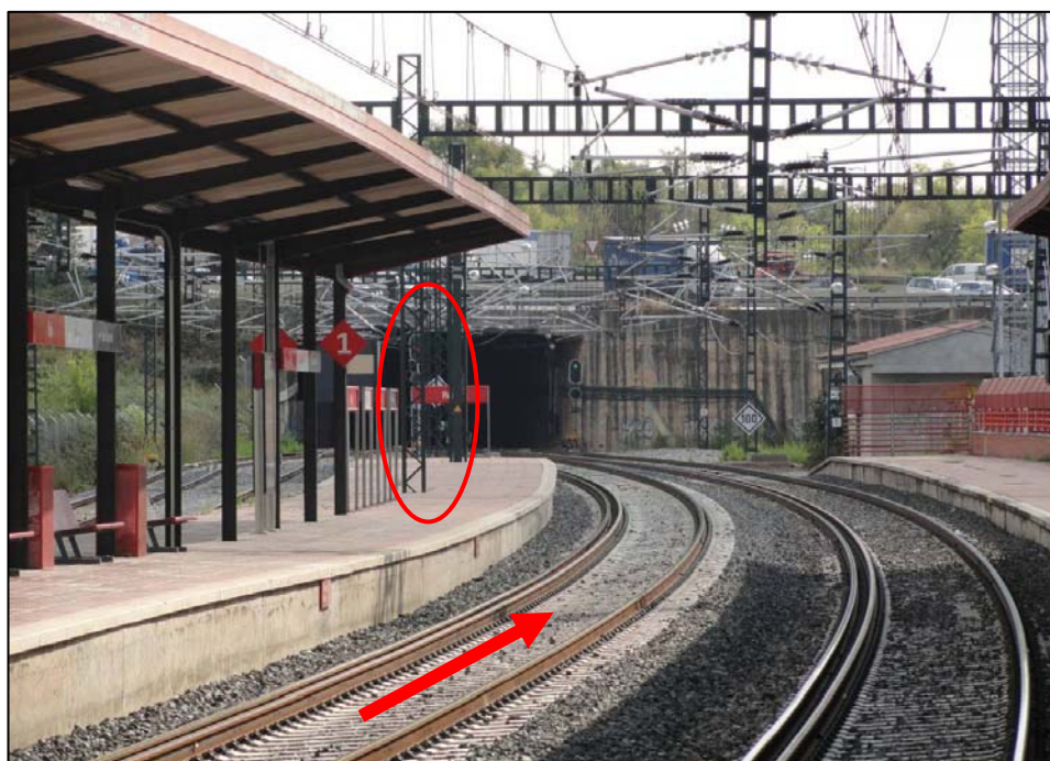
Vista de la señal de salida S1/1 de la estación de Rubí al paso por el andén.
