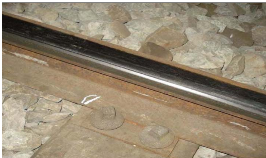
Punto "0" del descarrilamiento PK 11+758 en el interior del túnel del Caracol (Fuente: Adif)
