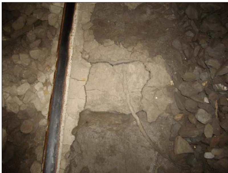
Detalle de balasto contaminado dentro del túnel. (Fuente: Adif)
