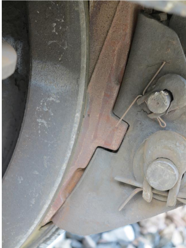
Figura 24 - Esempio di ceppo in condizioni anomale di lavoro e di usura
