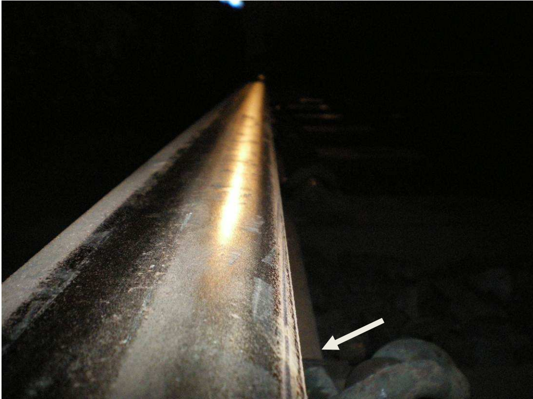
Figura 13 – Segni sulla rotaia sinistra smt dovuti alla caduta della ruota
