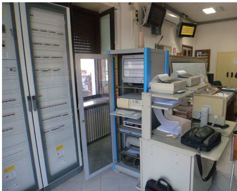
Figura 47 – Rack PdC RTB di Priverno - Fossanova
