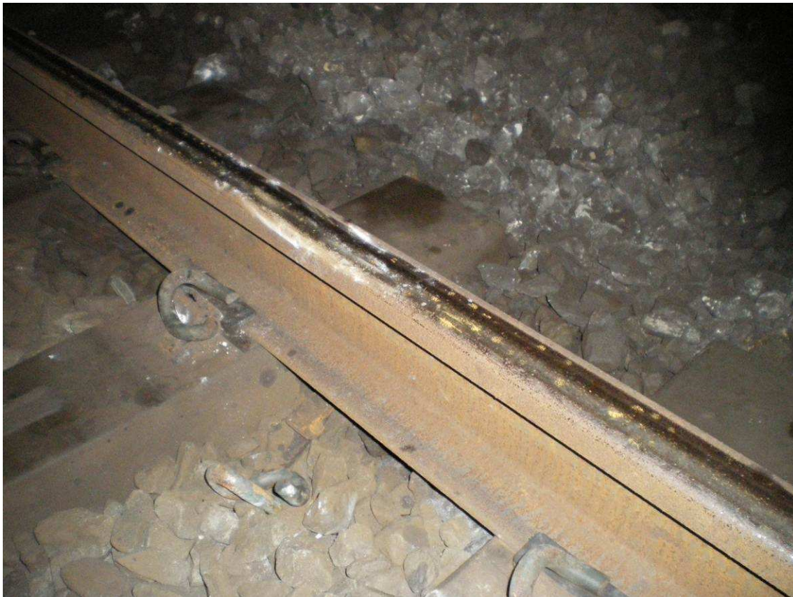
Figura 10 - Primo punto di sormonto (km 118+648, rotaia destra smt, binario dispari)
