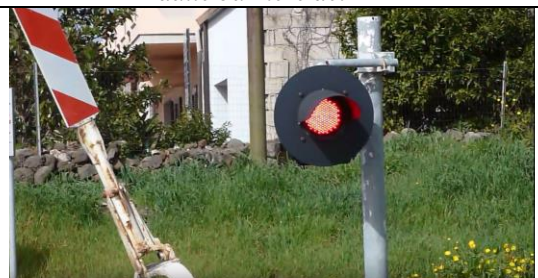
Figura 30 – Lanterna semaforica di avviso attiva mentre le barriere si abbassano
