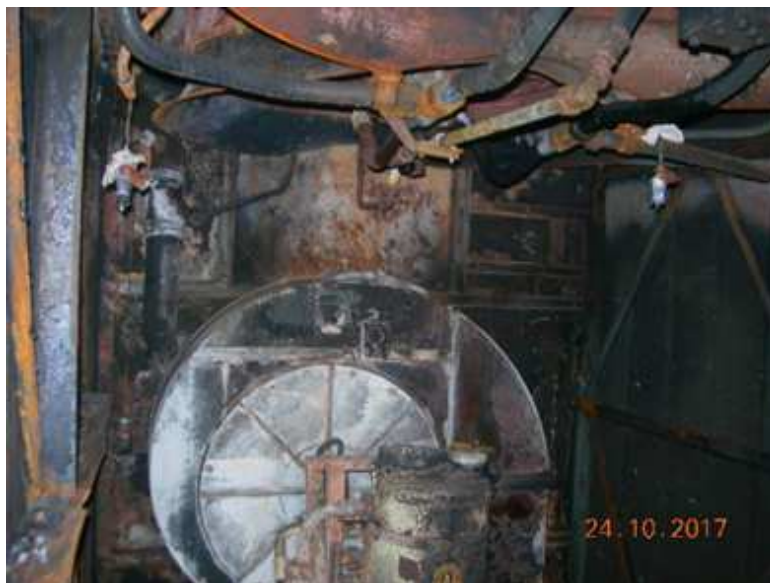
Figura 17 - Vano radiatori (fonte Mercitalia Rail)
