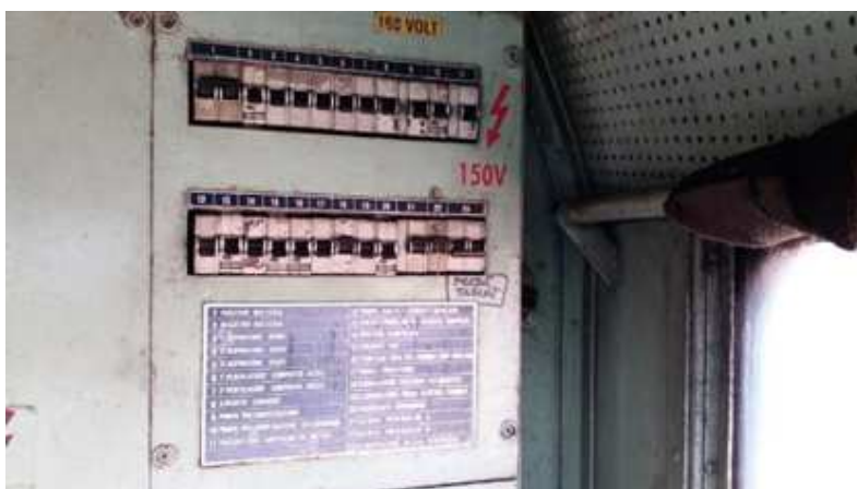
Figura 18 - Quadro interruttori automatici cabina B (fonte Mercitalia Rail)
