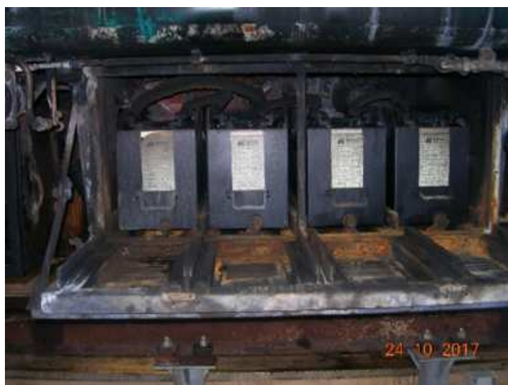
Figura 5 - Vano batterie (fonte Mercitalia Rail)
