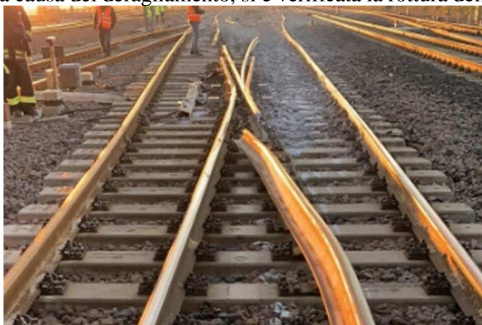
Figura 8 – Punto iniziale di svio: deviatioio 05 al km 166+756 (fonte: web)
