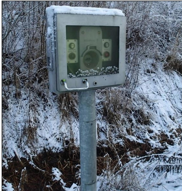
Kuva 19. Esimerkki ratapihalle sijoitetusta vaihteiden ohjaustaulusta. (Kuva: OTKES)
