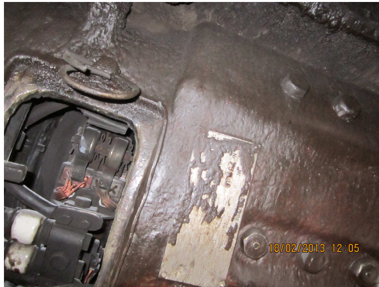
Fig.9 Starea de curățenie a motoarelor de tracțiune
