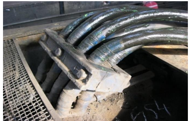
Foto nr.24 stare normală a jugului de fixare a cablurilor la intrarea în motorul de tracțiune
