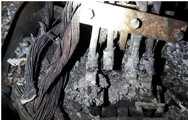
Foto nr. 23 stare existentă a jugului de fixare a cablurilor la intrarea în motorul de tracțiune
