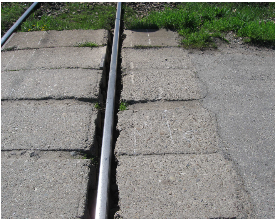
Fig.nr.14 Urmele de deraiere a boghiului peste pasajul de la TN 490+365
