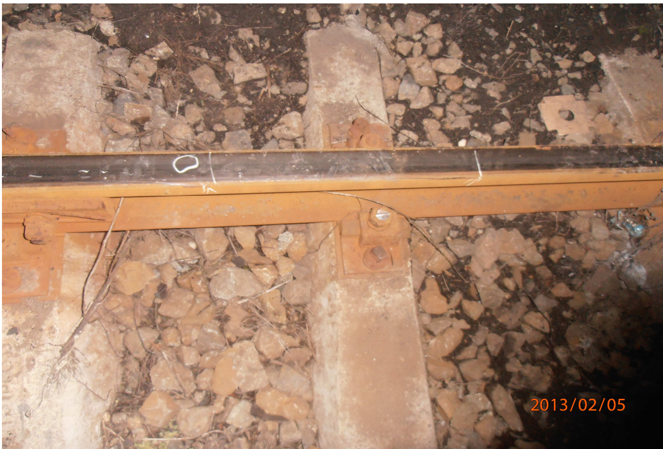
Foto 1. Locul escaladării șinei de către roata din dreapta a primei osii de la vagon.
