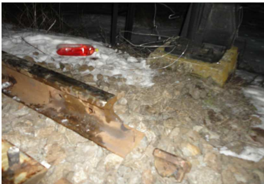
Foto 2 : Capătul rupt al șinei din alcătuirea joantei
