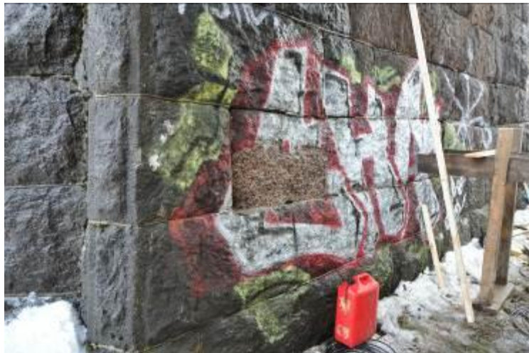
Figur 10. Skador på östra sidan efter att ämnet åkt av vagnen.
