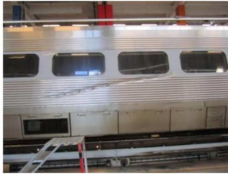
Figur 28. Bild på skador under fönster 4 – 5.
