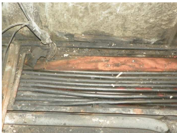
Fig.15 Cablaj de forță din canalul cu cabluri pe lungimea cutiei locomotivei
