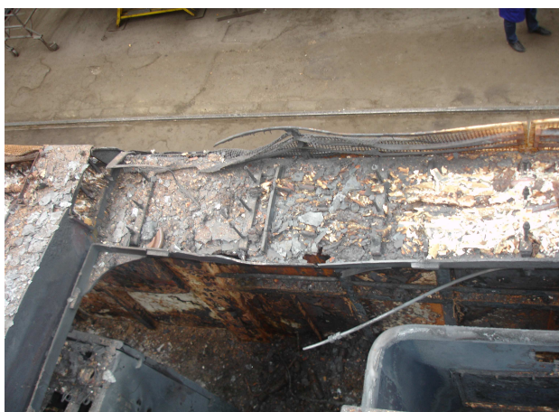
Foto nr.8 – canal cablaj electric de forță din dreptul blocului S4
