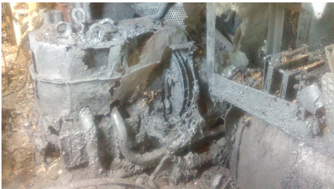
Foto nr.9 – compresor principal nr.2
