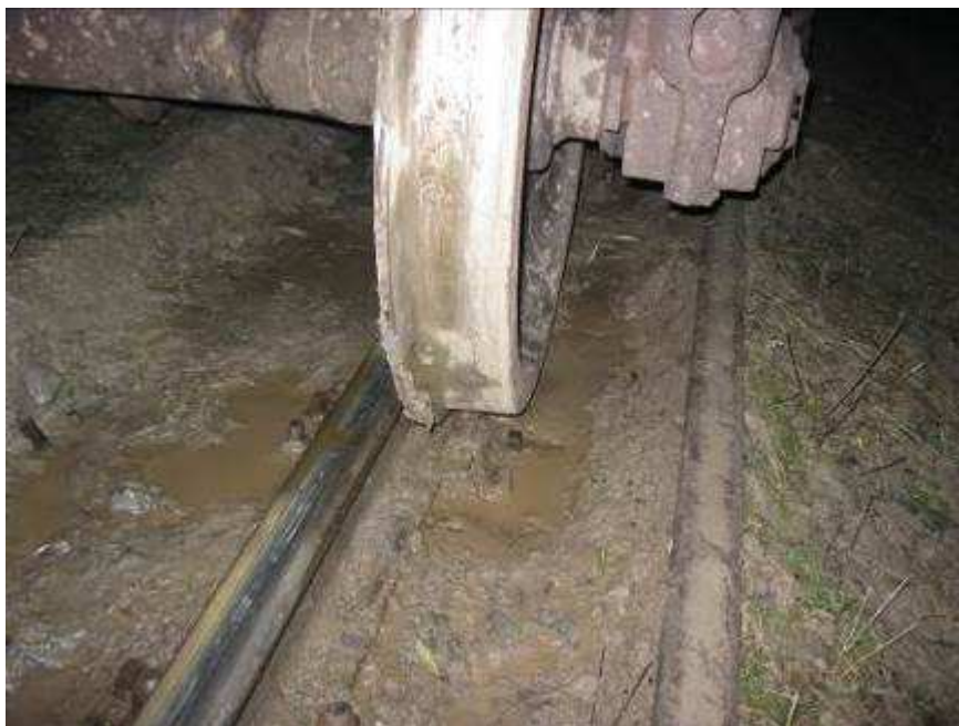
Foto nr.6 Roata din dreapta a osiei IV, în sensul de mers, de la vagonul al 3-lea, după escaladarea șinei corespunzătoare firului interior al curbei și căderea în exteriorul căii, pe partea dreaptă
