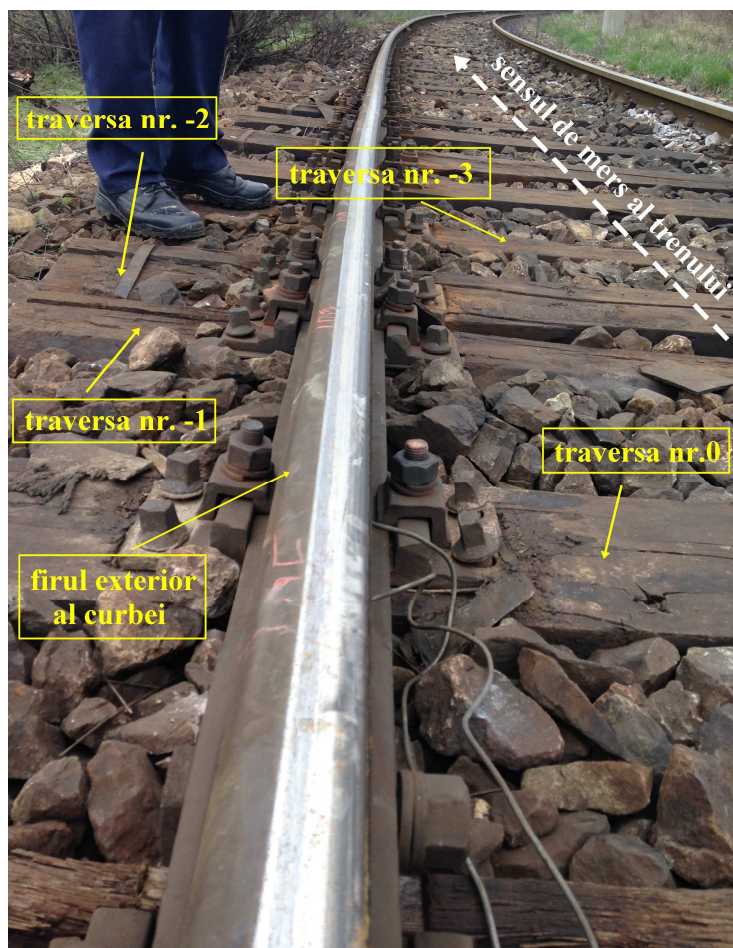
defectele traverselor nr.0 ÷ -3 capetele traverselor dinspre firul exterior al curbei
