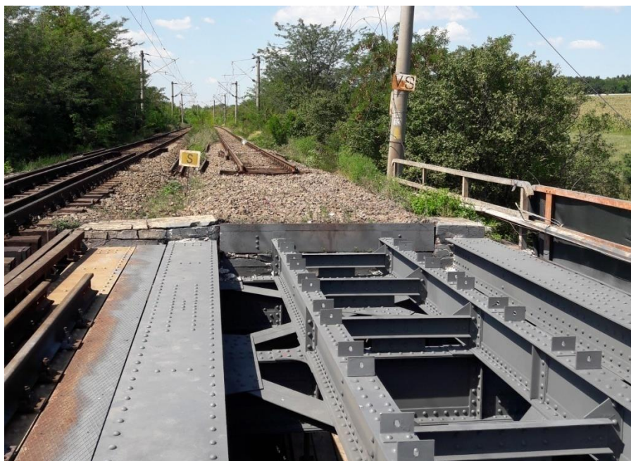
Foto nr. 8-Terasamentul din spatele culeei Banu Mărăcine (culeea C2) șine, contrașine interioare și traverse sunt scoase din cale
