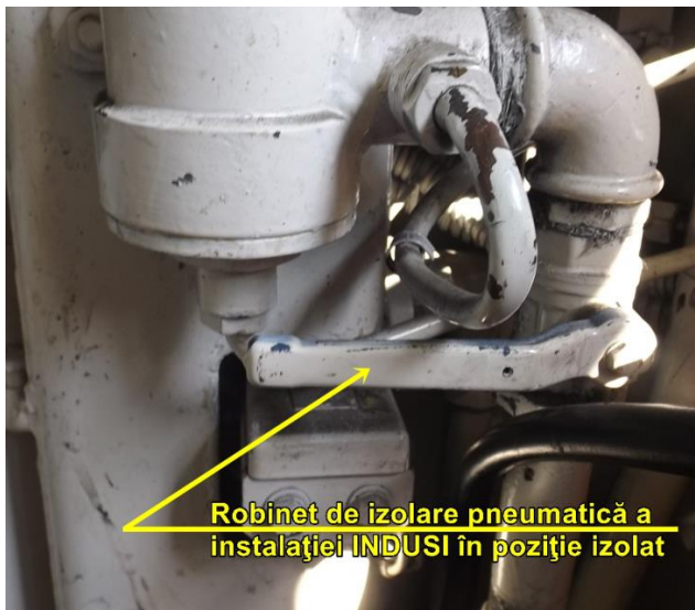
Foto nr.23 - robinet de izolare pneumatică izolat
