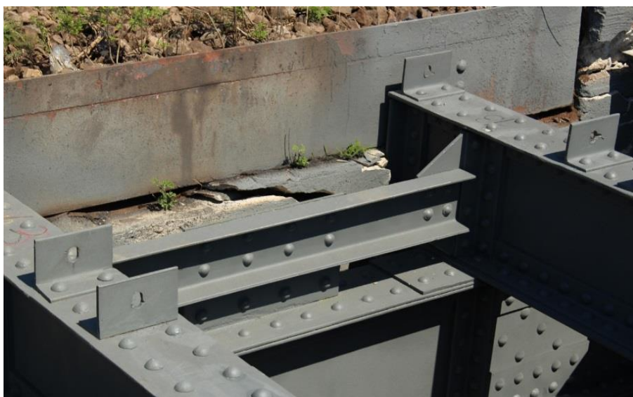
foto nr.16 - distrugerea părții superioare a culeei C2 datorită împingerii exercitată de tablierul III în urma șocului primit de la tablierul II
