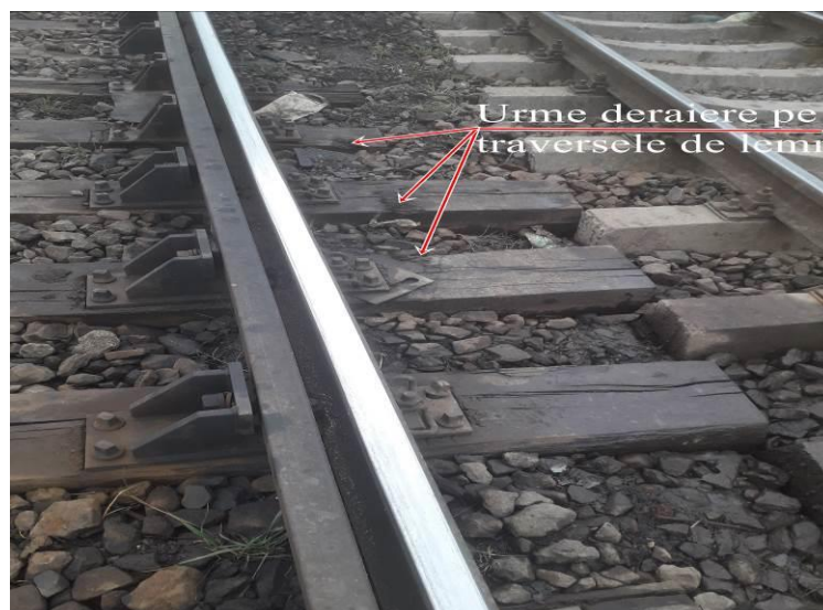
Foto nr.3 – urmele de lovire a traverselor de lemn de către roțile deraiate
