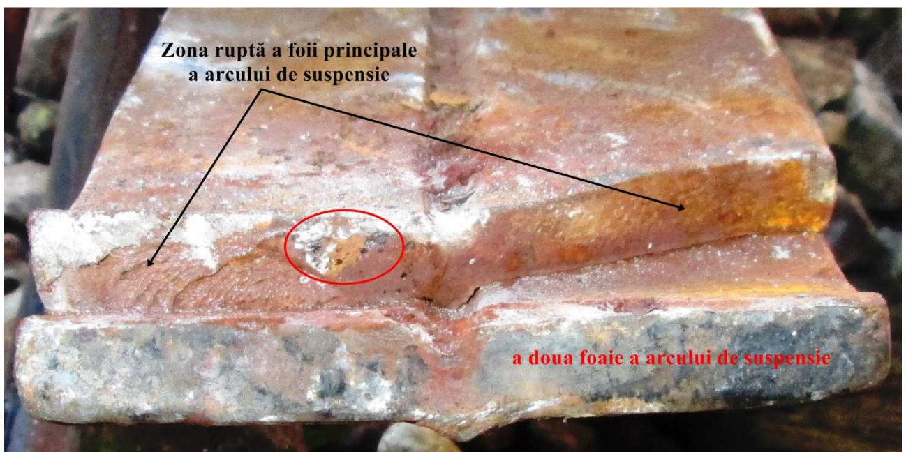
Fotografia nr.6 – Aspectul zonei rupte pe foaia principală a arcului de suspensie După preluarea, arcului de suspensie împreună cu ochiul foii principale și piesele atelajului de suspensie aferente, de la Postul de Poliție TF Ploiești Sud:
