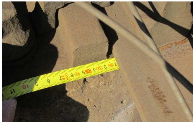
Foto nr.4: Uzură placă
