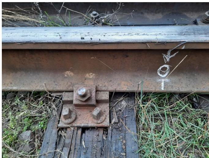
Foto nr.5 - Prima urmă de cădere la km 2+773 - punctul „0”
