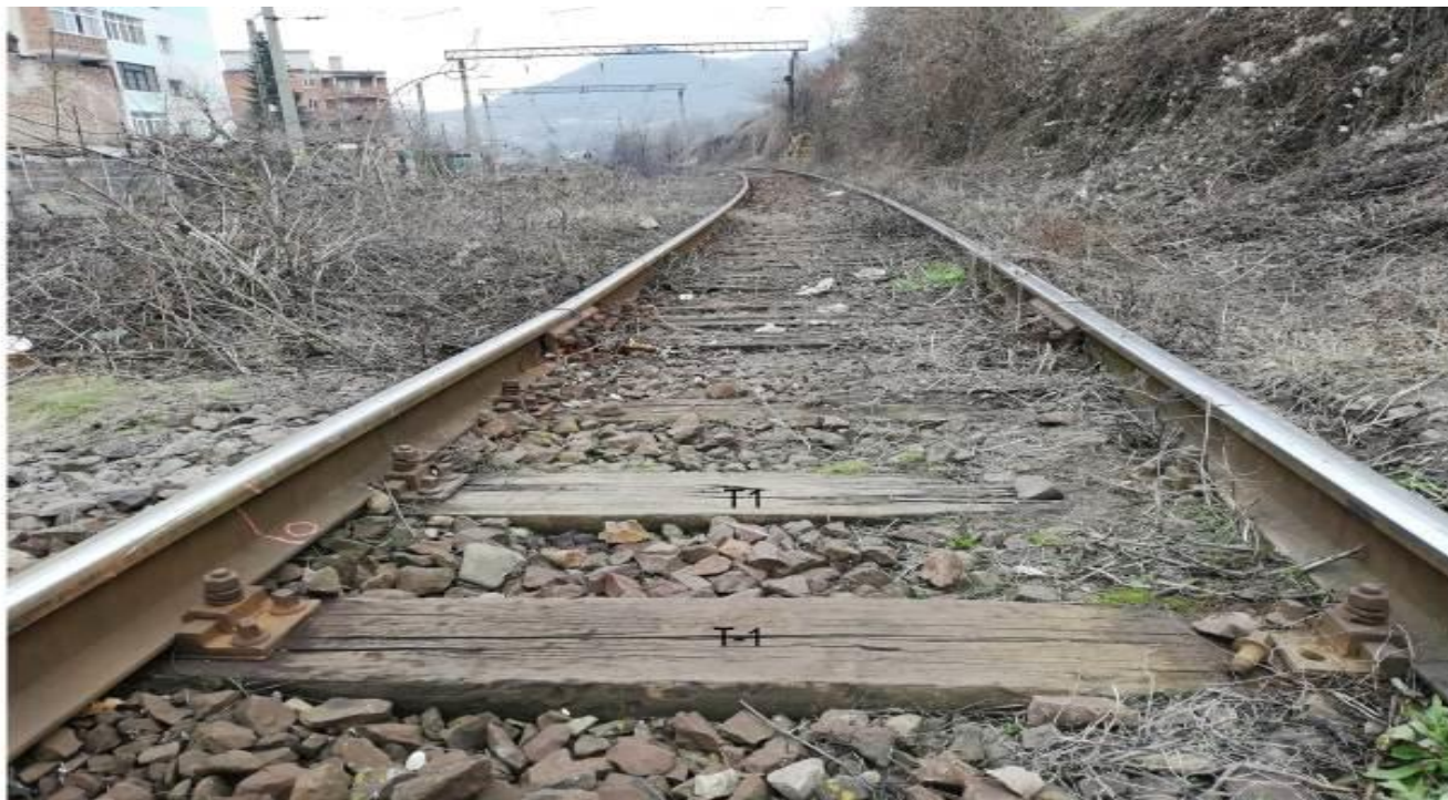
foto 6 : starea traversei T-1 și a traversei T1
