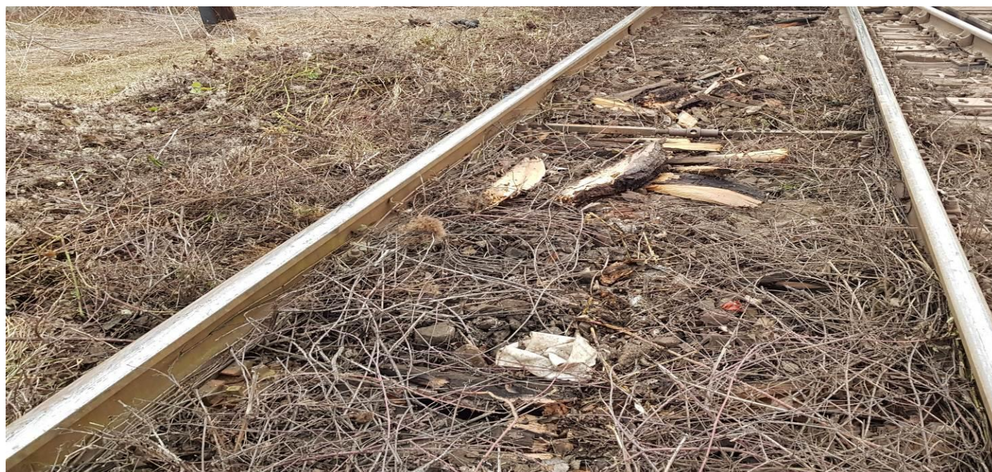
foto 2: afectarea suprastructurii feroviare
