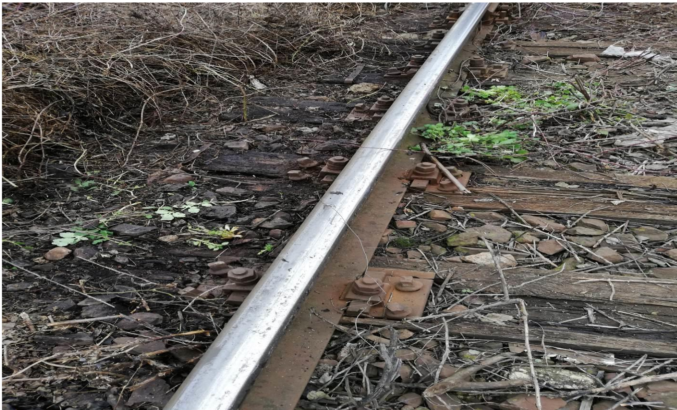
foto 10: starea traverselor pe zona punctului „0”
