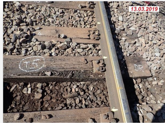
Foto nr.9 -Traversa T 5 în cale
