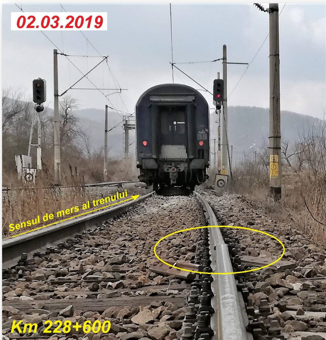
Foto nr.2 – Prag lateral pe firul de șină din dreapta căii, firul exterior al curbei
