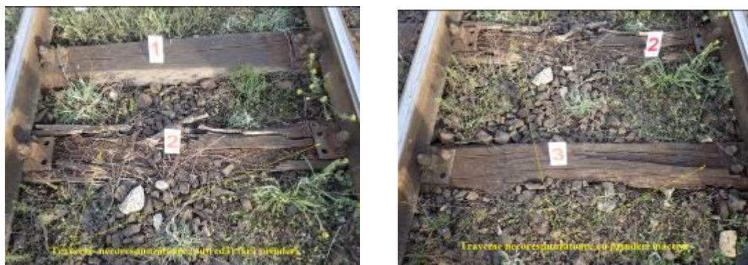
Fig. nr.3 – Zona premergătoare locului producerii deraierii
