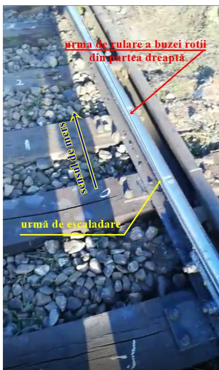
Fig. nr.4 - Urmele de deraiere pe acul curb al schimbătorului de cale nr.31
