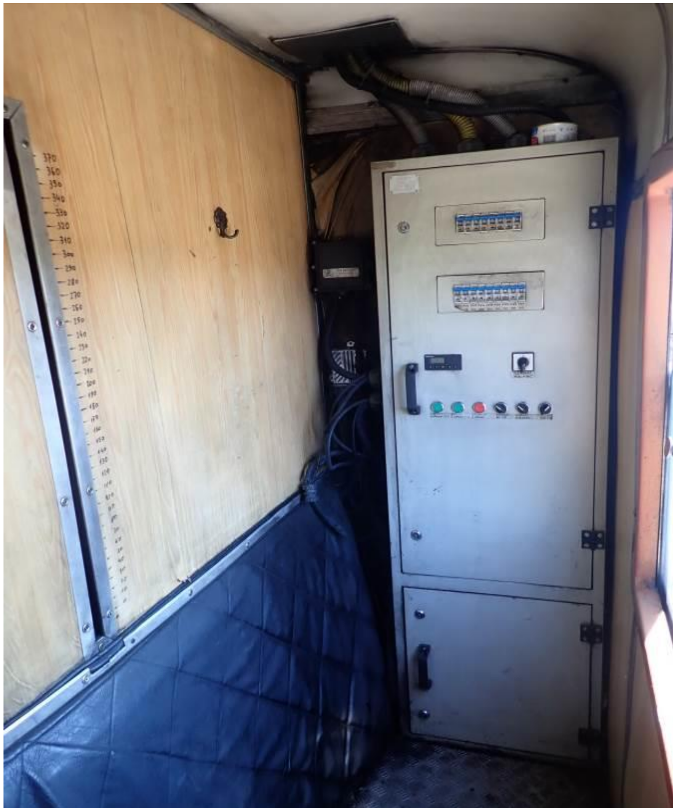
Foto nr.9–Poziționarea tabloului electric și a indicatorului „sticlă de nivel” combustibil
