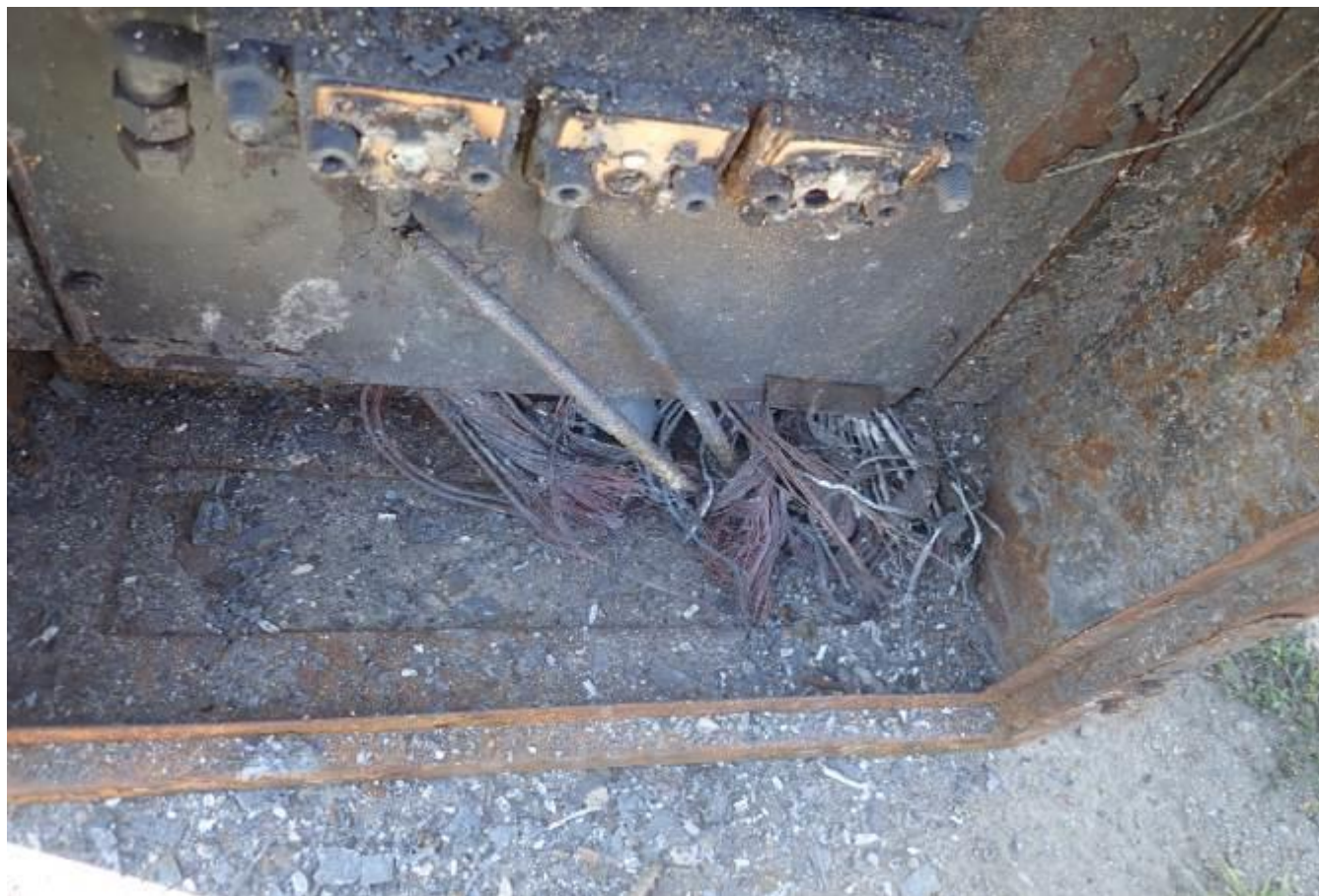
Foto nr.7–Carcasa tabloului de siguranțe electrice și relee.
