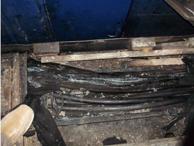
Canal de cabluri sala mașini (foto. 7)
