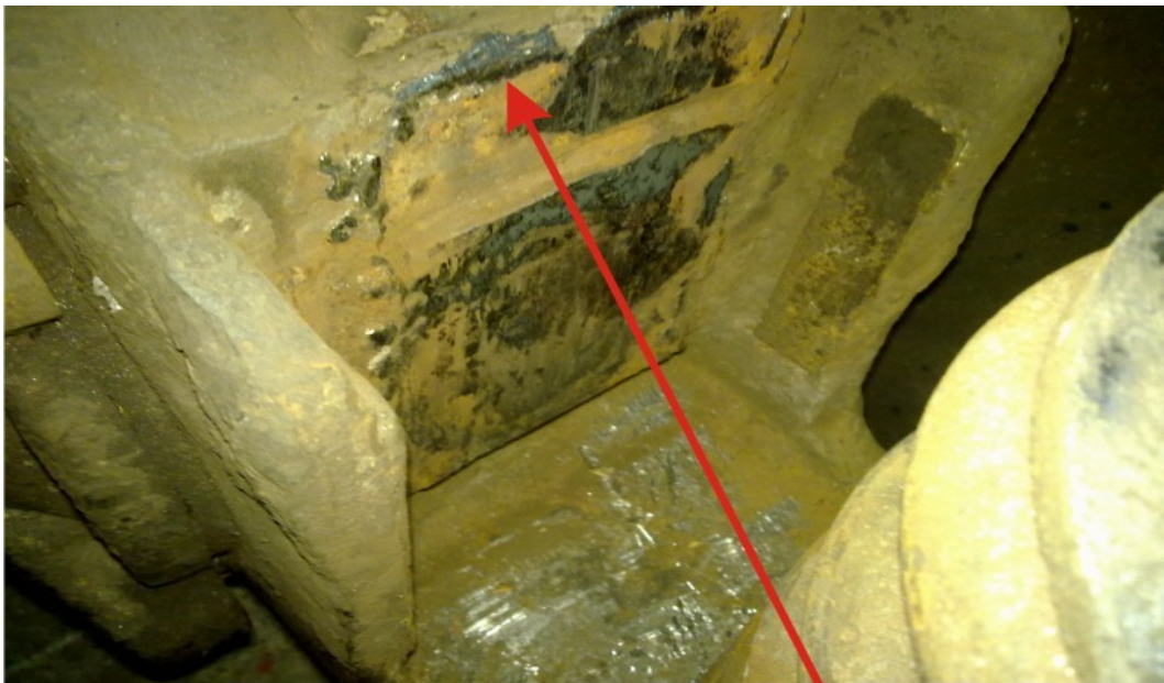
cordonul de sudură rupt
