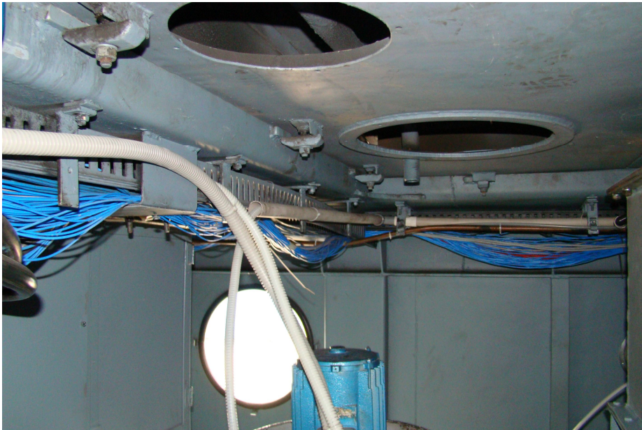
Foto 15 - Cablurile electrice au fost trase în mănunchi , printr-o tubulatură ( Fotografie făcută în timpul montării electrocompresorului )
