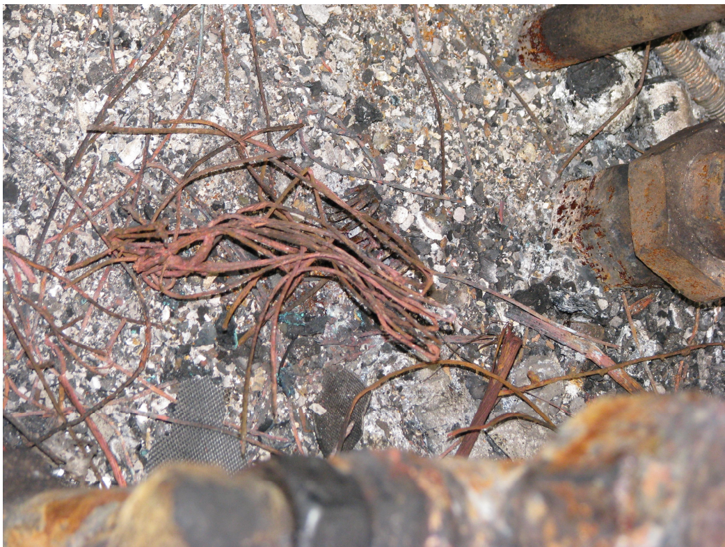
Foto 10 - Mănunchi de cabluri din circuitul de alimentare a motorului electric ventilație compresor și din circuitul de supraveghere a funcționării compresorului, topite și sudate între ele de cuprul topit
