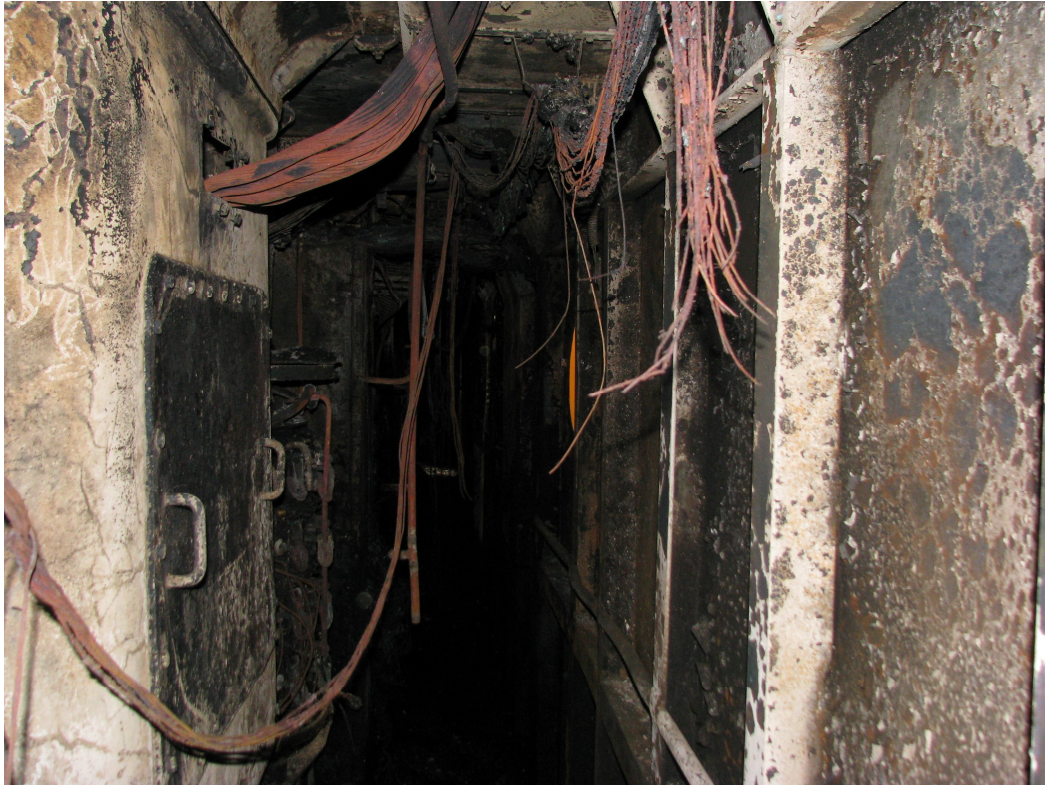
Foto 3 - Cablajele cu izolatia arsa
