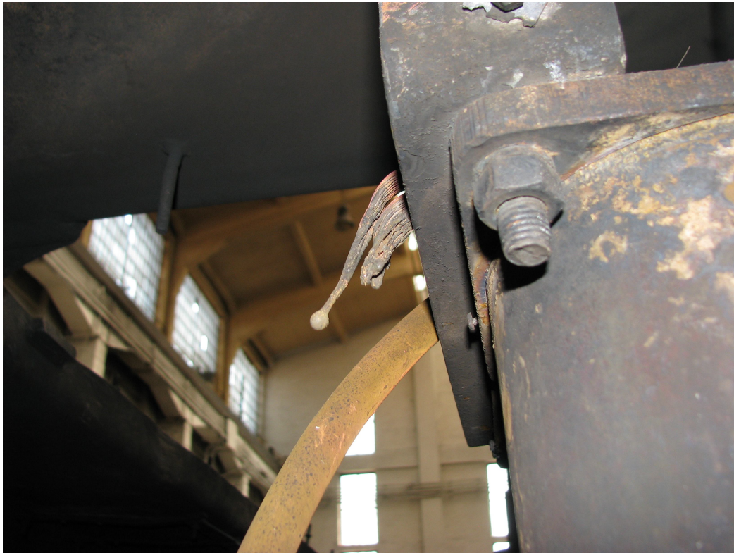
Foto 9 - Cablurile motorului electric de actionare a compresorului - amplasate deasupra bateriei de silicagel – prezinta topitura de cupru
