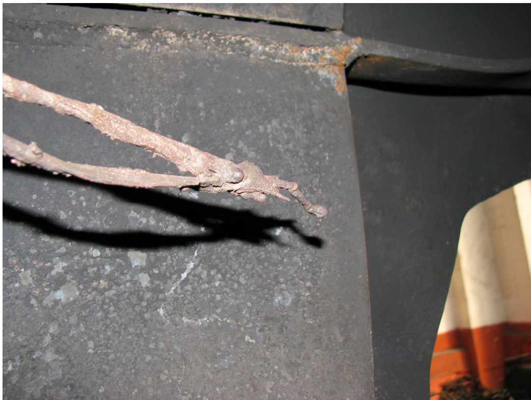
Foto 8 - Cablurile motorului electric de acționare a compresorului – sudate deasupra culoarului de acces
