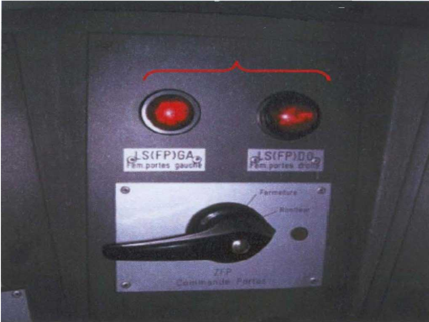
Annexe 4-2 : alarmes perçues par le conducteur en cabine lors de l'ouverture d'une porte après actionnement d'un SAI (cliché SNCF)
