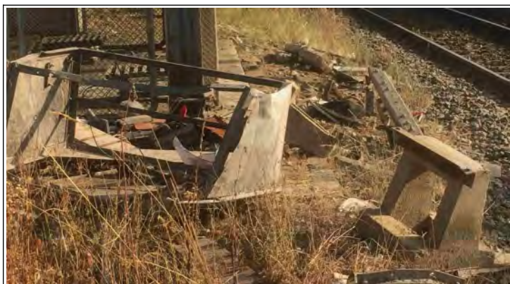
Figure 57 : illustration des dégâts sur le circuit d'alimentation 8 V suite à l'accident (photo BEA-TT)
