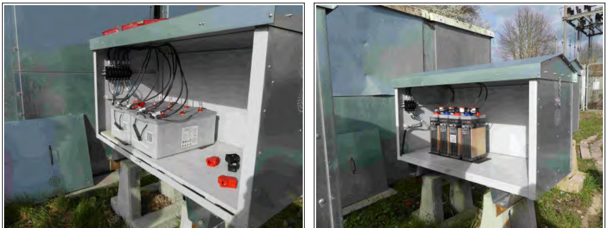
Figure 56 : vues des accumulateurs 24 V (photo de gauche) et 8 V (photo de droite) remplacés après l'accident (photos BEA-TT)
