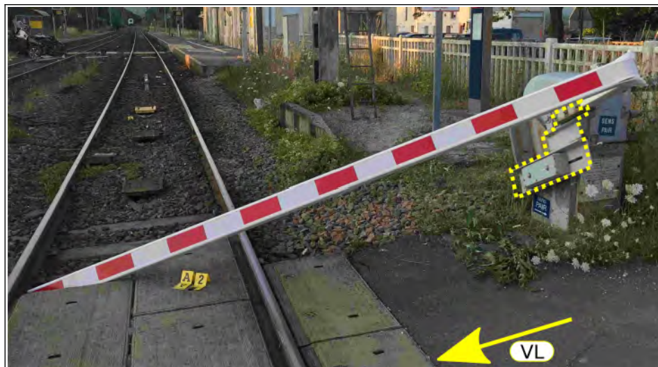
Figure 50 : état de la lisse de la demi-barrière accidentée (photo Gendarmerie nationale, légendée BEA-TT)
