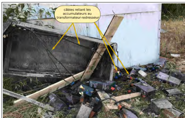
Figure 58 : illustration des dégâts sur le circuit d'alimentation 24 V (photo SNCF, légendée BEA-TT)
