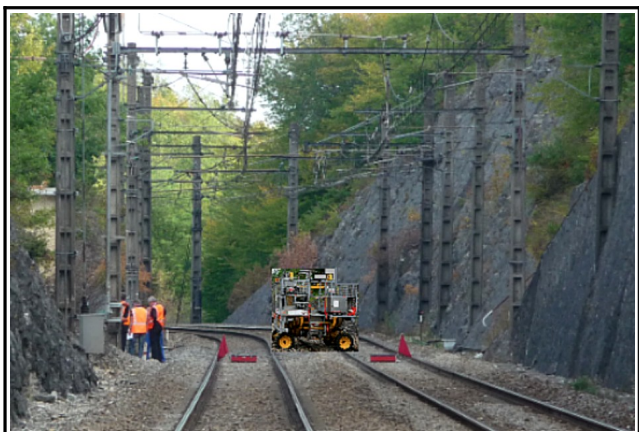
Vue 3 - La voie 2 au niveau du PK 528,500 avec les agents et l'engin de maintenance des caténaies.
