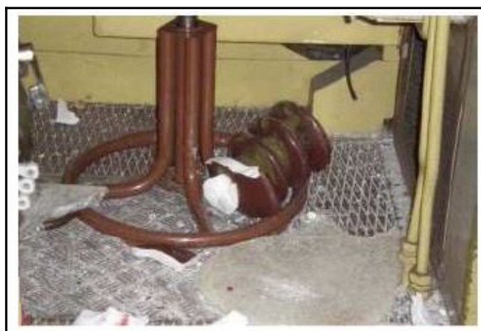
Figure 2 : Morceau d'isolateur retrouvé sur le plancher de la cabine
