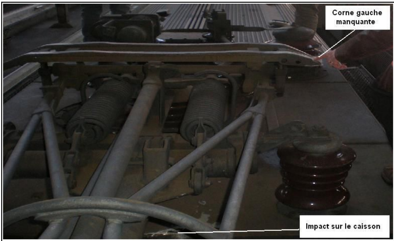
Figure 25 : Vue du pantographe et de la toiture de la Z 6155 après l'accident
