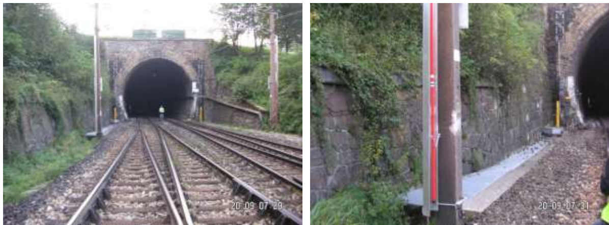
Abbildung 11 Kollisionsspuren am Oberleitungsmast und am Portal Tunnel „Weinzettelfeld“ - Quelle IM
