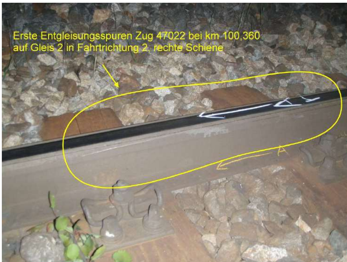
Abbildung 7 Erste Entgleisungsspuren km 100,360 - Quelle IM
