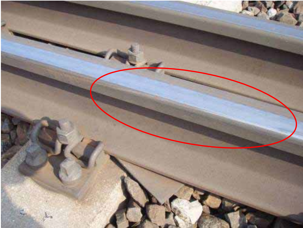
Abbildung 12 Entgleisungsspur auf der Weiche 10 im km 143,200
