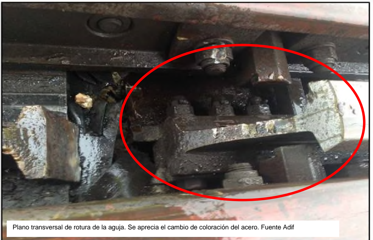
Detalle del punto donde se inicia la rotura de la punta del corazón móvil. Fuente Adif
