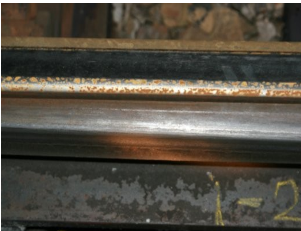
Obr. č. 5: Stopy po okolku na jazyku výhybky – 2 m za „bodem nula“
