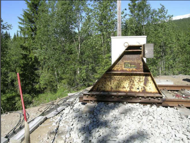
Figur 9: Endebuttstokk med ødelagt kabelkanal.
