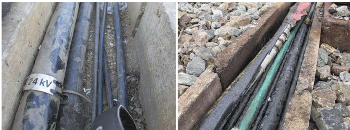
Figur 34 og 35: 24 kV kabel i kabelkanal sammen med tele- og signalkabler ved Hallingskeid. (Kilde: Jernbaneverket)
