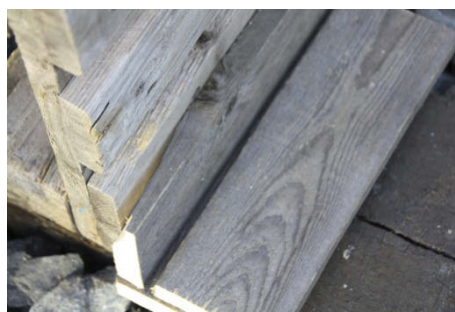
Figur 5-4 Spalte (av planker fra Hallingskeid).
