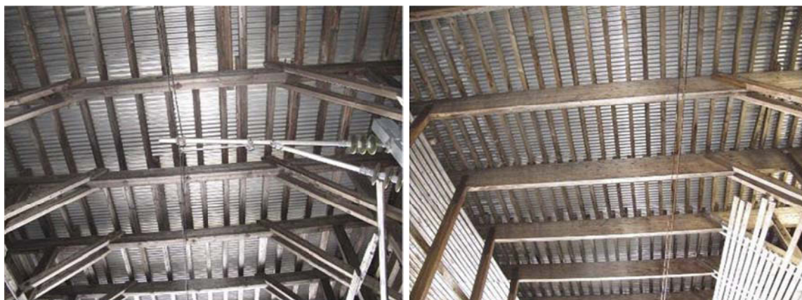
Figur 44 og 45: Takkonstruksjon i snøoverbygg øst og vest for stedet hvor det brant.
