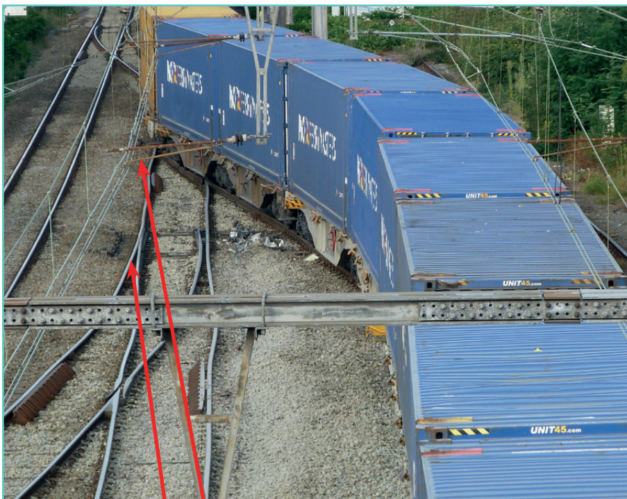
Vue d'ensemble des aiguillages 04S et 02S ayant subi des dégâts lorsqu'ils ont été parcourus par le wagon n°7 déraillé
