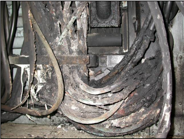
Figur 2 Brannskader på høyspentkablene for hovedtransformatoren nede ved gulvet.
