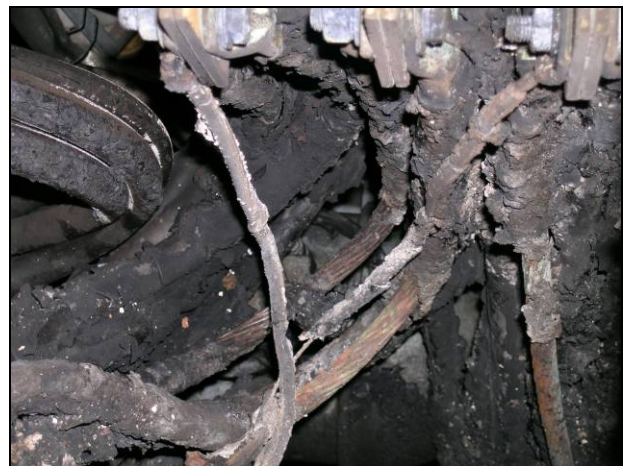
Figur 5 Detaljbilde av utbrente kabler. Koblingsklemmene sees i bildets overkant
