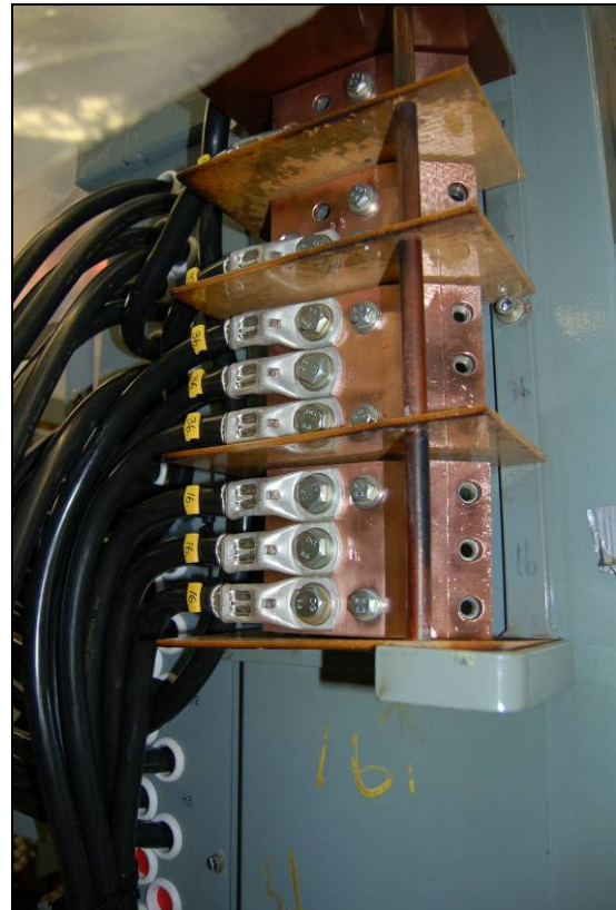
Figur 9 Nye høyspentkabler koblet til strømskinne.
