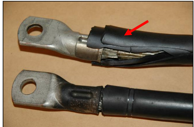
Figur 7 Viser kabelisolasjon som var oppsmuldret, påvirket av oljelekkasjene. Nedre kabel har ikke vært utsatt for olje og er OK.
