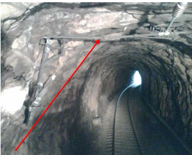
Figur 2: Viser skadet utligger for kontaktledningen.
