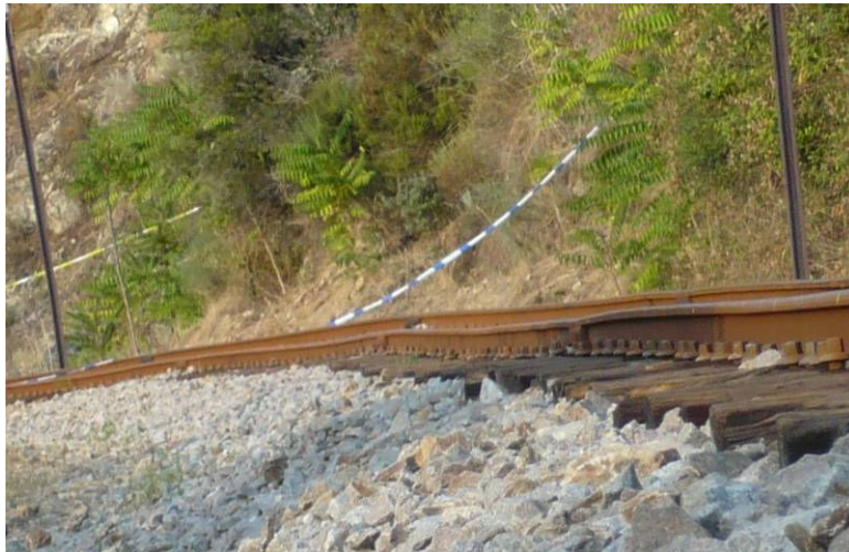
Foto 2 – Aspecto das irregularidades patentes na via, na curva e à saída desta, na curva de transição
