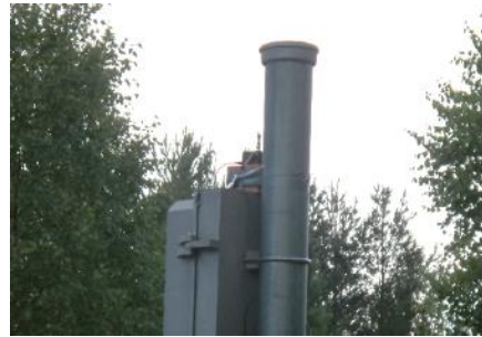
Kamera ved innkjørsignal A, forsignal L/N. Foto: SHT
