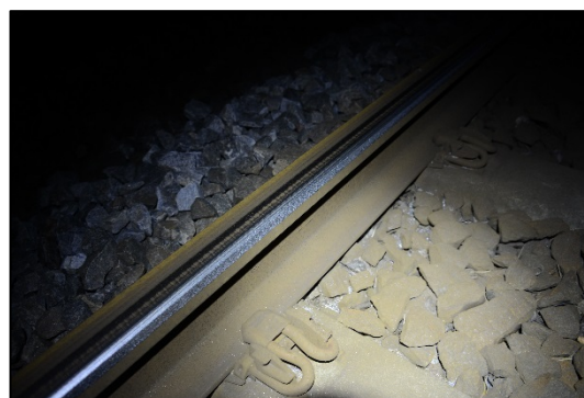
Figur 6: Slitasje på venstre skinnegang. Foto: SHT
