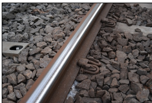
Figur 5: Venstre skinnestreng, spon fra skinner i ballast. Foto: SHT
